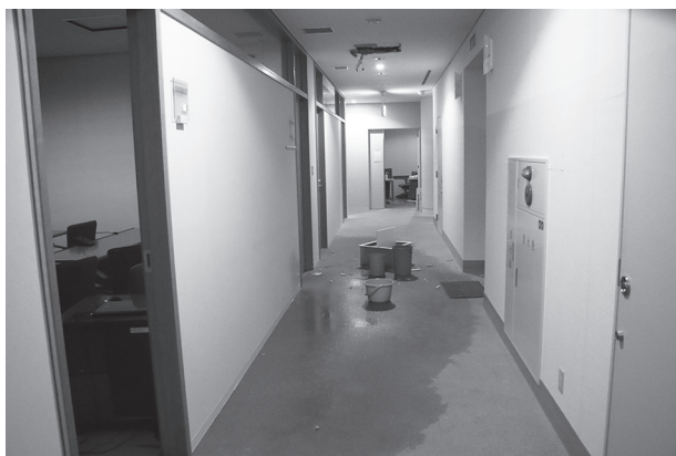
【役場庁舎内漏水】
