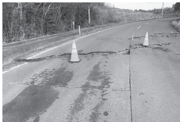
【町内の道路に大きな被害】
