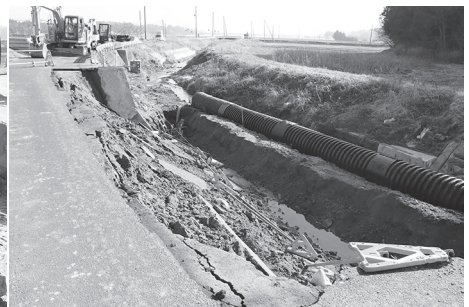
三滝川の堤体崩落
