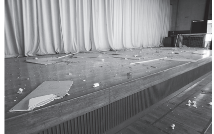
▲体育館ステージの状況
