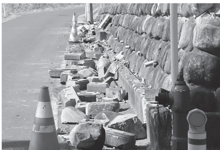
ブロック塀の被害
