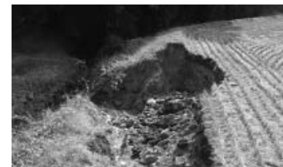
▲のり面が崩落した駒ヶ嶺赤柴地内の田（10月10日撮影）
