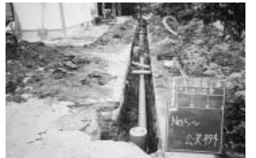
▲宅内排水設備の様子
