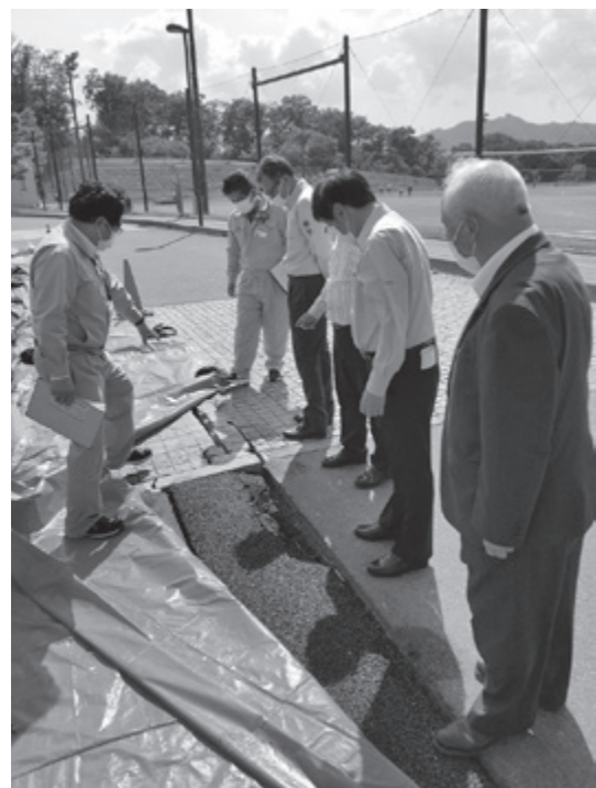
▲地割れや段差が生じた総合運動公園内
