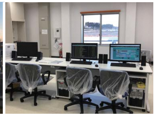
地区内のエネルギー消費量などを管理し、機器の運転を制御する中央監視室
