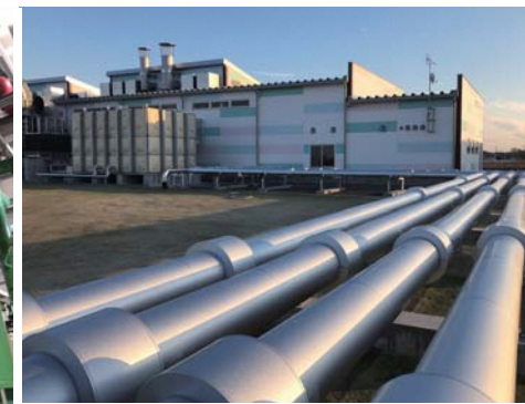
エネルギーセンターから各施設へエネルギーを運ぶ供給配管（地域導管）
