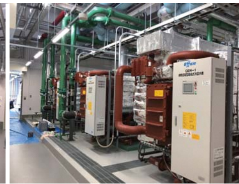
ガス吸収式冷温水機
