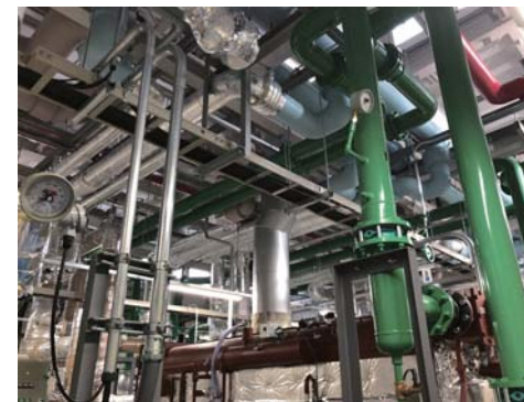
建物内にはりめぐらされた配管
