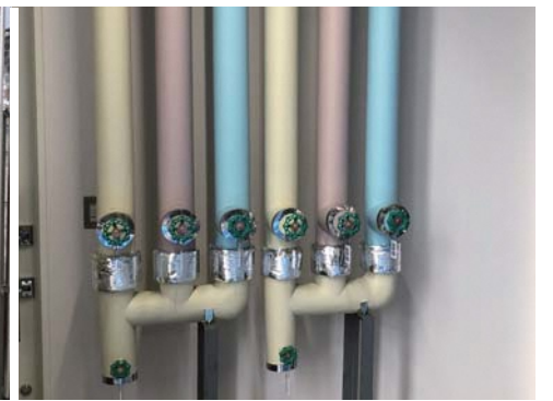
見学者にわかりやすいよう、温水・冷水・冷温水（季節で使い分け）で色分けされた配管
