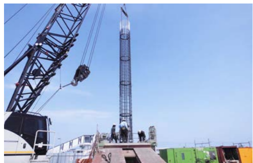
口径1.1～2.0m、長さ12～21mの杭を29本打設します。現場で穴を掘り、鉄筋を挿入後、コンクリートを打設し、杭を造成します。
