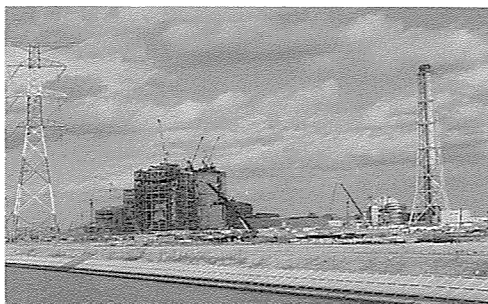
▲ 今年11月に試運転が始まる新地火力発電所
