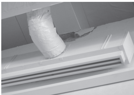
揺れにより外れた空調ダクト
